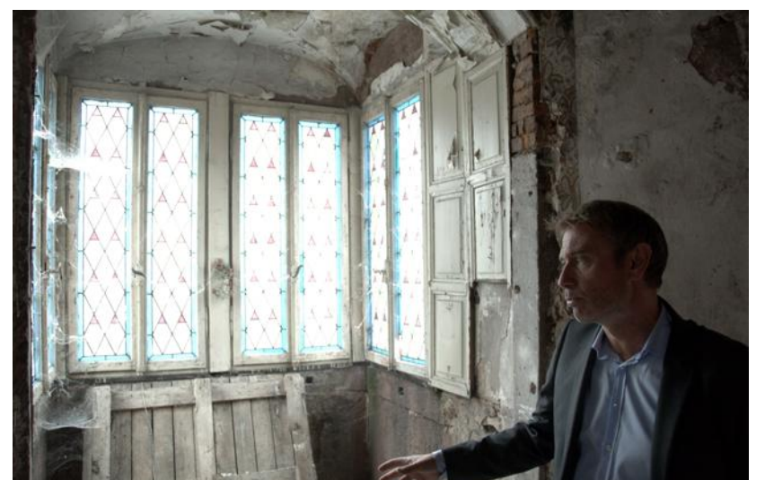
Frédéric Godeck, directeur de Ventim, veut « intégrer l'oriel dans les logements pour apporter de la lumière ».
